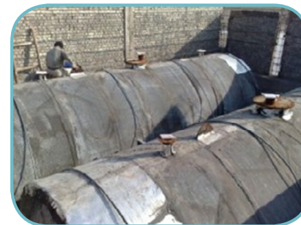
محل دفن مخازن ایجاد محل دفن مخازن و اجرای پایپینگ و دیپ گیری مخازن
